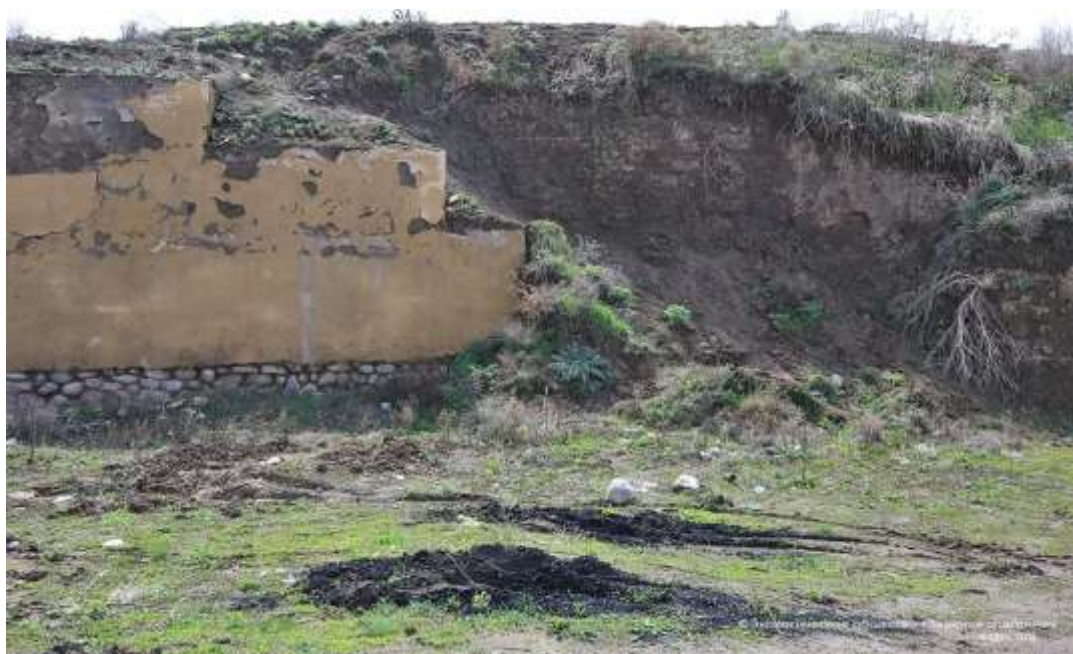
Фото 16. Разрушающаяся оборонительная стена.
